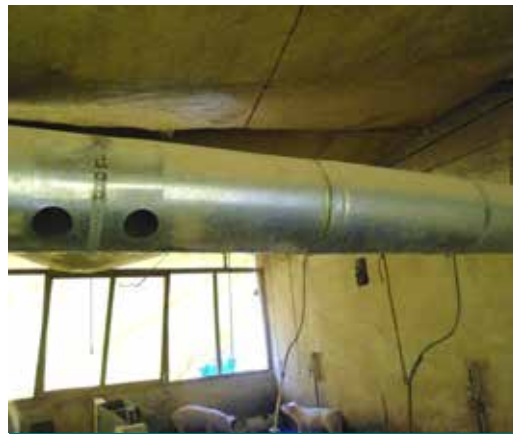
Figura 27. Sistema de aquecimento de ambiente de creche: caldeira a biogás e ar quente.
