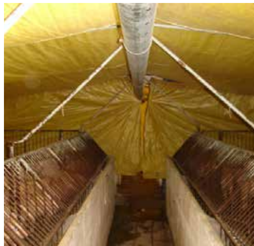
Figura 28. Sistema de aquecimento de ambiente de creche: caldeira (duto de ar quente) e lona.
