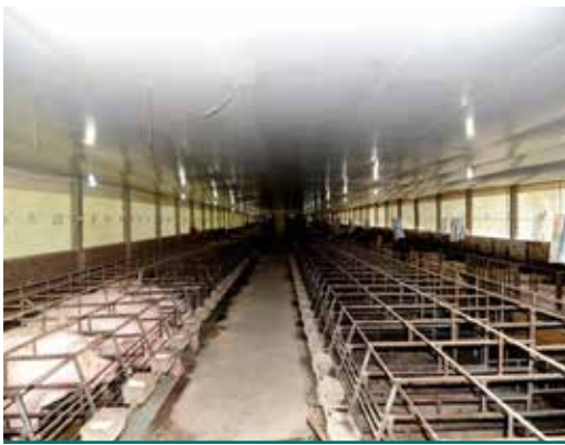
Figura 11. Sistema de pressão negativa: exaustores e forro.
