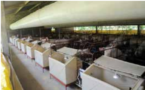
Figura 15. Escamoteadores com aquecimento e sistema de ar resfriado (duto) para as porcas. O sistema de ar resfriado sobre a cabeça das porcas não altera significativamente a temperatura da sala, mas determina melhor sensação térmica das matrizes.
